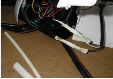
サーボモータの接続部です。
